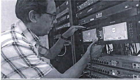
Limpieza de monitores de video
