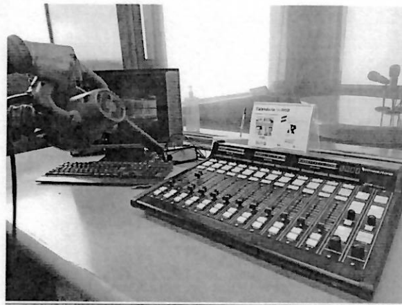
Limpieza de consola de transmisión y prueba de funcionamiento de los canales.
